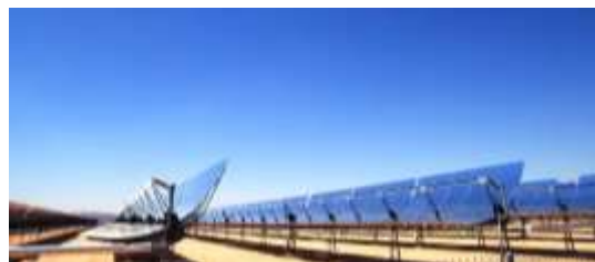
源和电站的槽式太阳能热发电系统
